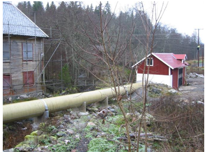
En ny tub med längden 285 m leder vattnet till turbinen som finns i det röda huset. Foto Tord D
